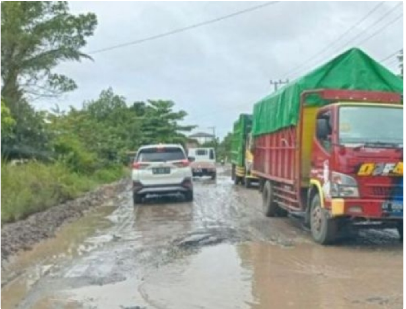
Kondisi Ruas Jalan Palangka Raya - Kuala Kurun, foto berbagai sumber
